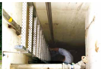
In diesem Schacht befinden sich die beiden Pumpen.
