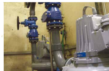
Die Pumpen an ihrem Einsatzort. Sie befördern Abwasser auf ein höheres Niveau.
